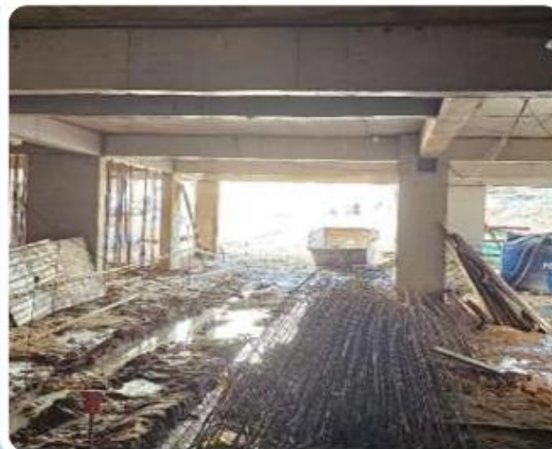
Foto 1 - Armazenamento de materiais diversos no subsolo.
